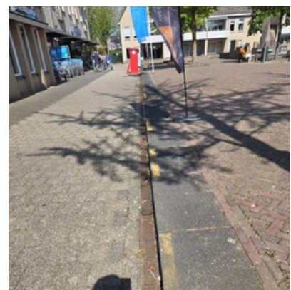
Slecht zichtbare overgang stoep
